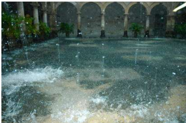
Figura 1: Imagem do claustro do Convento alagado em época de chuva (Fonte: Grifo, 2011)
