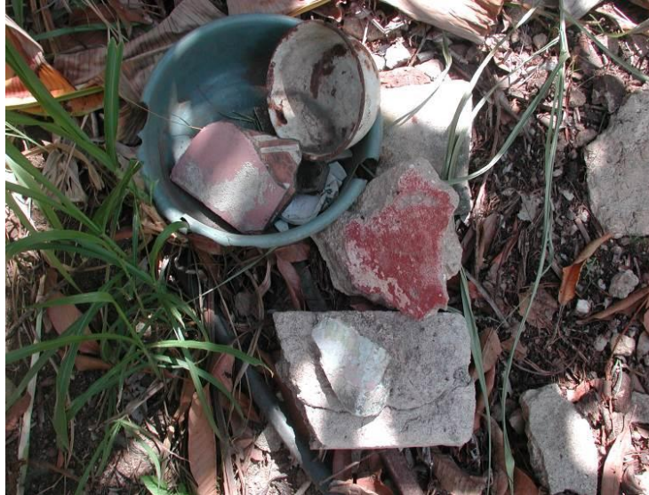
Figura 6 – Materiais do desmoronamento da cozinha (tijoleira, ladrilho hidráulico e argamassa)
