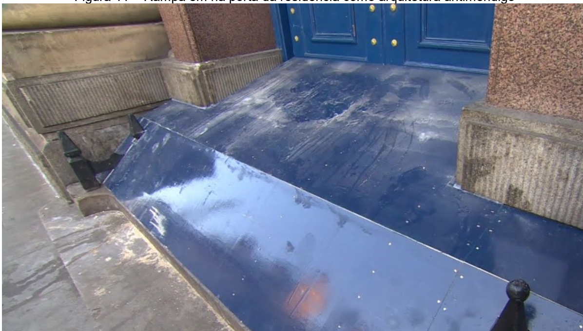
Figura 11 – Rampa em na porta da residência como arquitetura antimendigo
