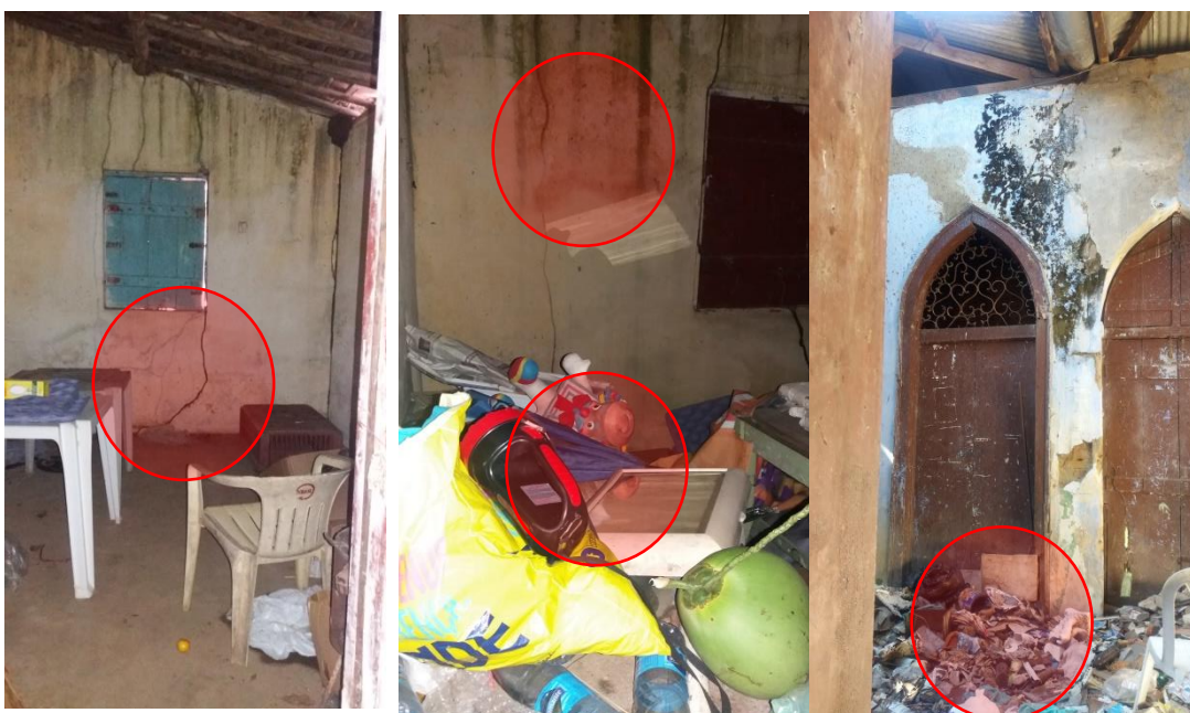
Figura 58 - Entulhos de objetos e focos de cupins no interior dos imóveis.
