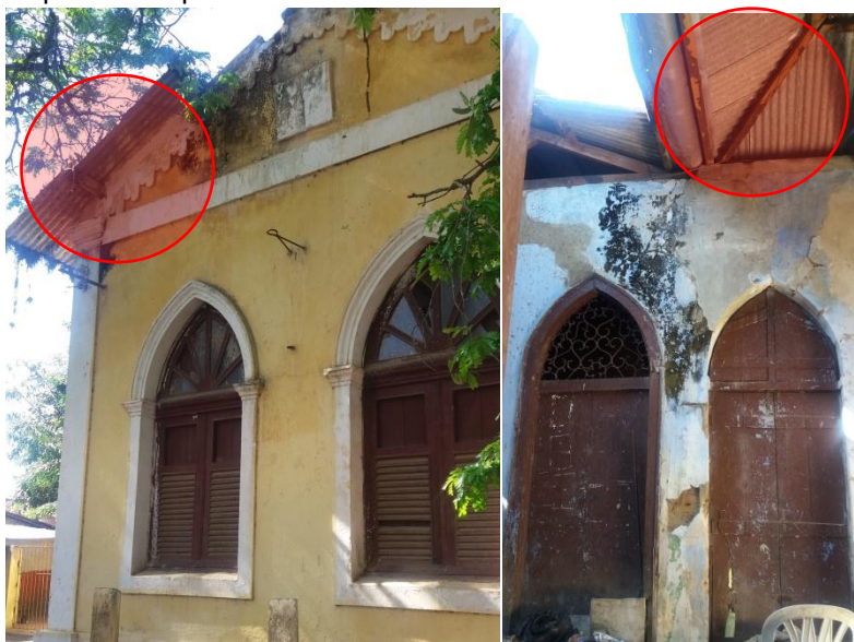
Figura 55 - Telhado de fibrocimento descaracterizando a tipologia arquitetônica primitiva
