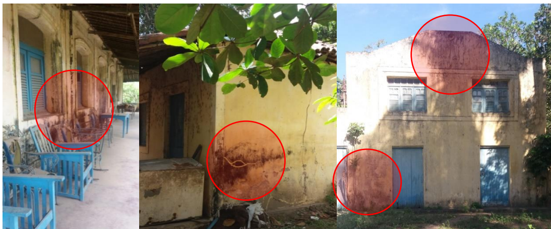
Figura 53 – Imagem mostrando as manchas de umidade encontradas na fachada da Casa- Grande (esquerda), da residência de um dos antigos proprietários (centro) e galpões (direita).
