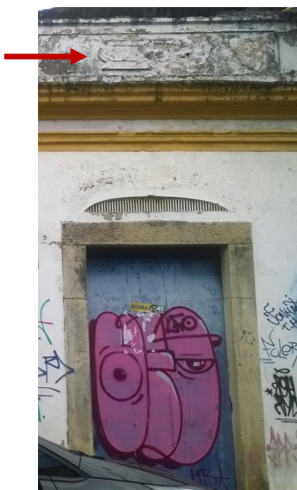
FIGURA 32: Perda de ornato e sujeidade
