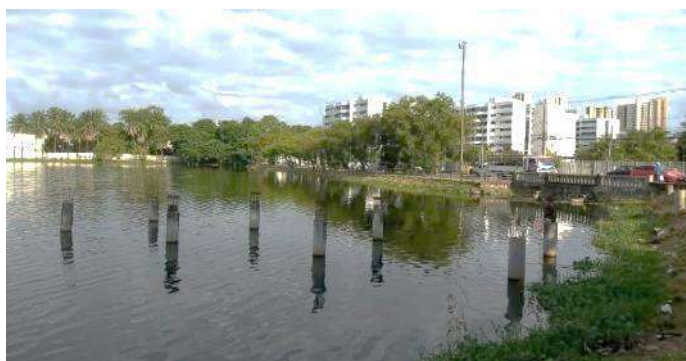
Figura 24 - Estruturas do píer inacabadas e com ferragem exposta.
