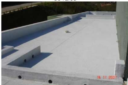
Figura 22 – Captação da água de chuva através de ralos
