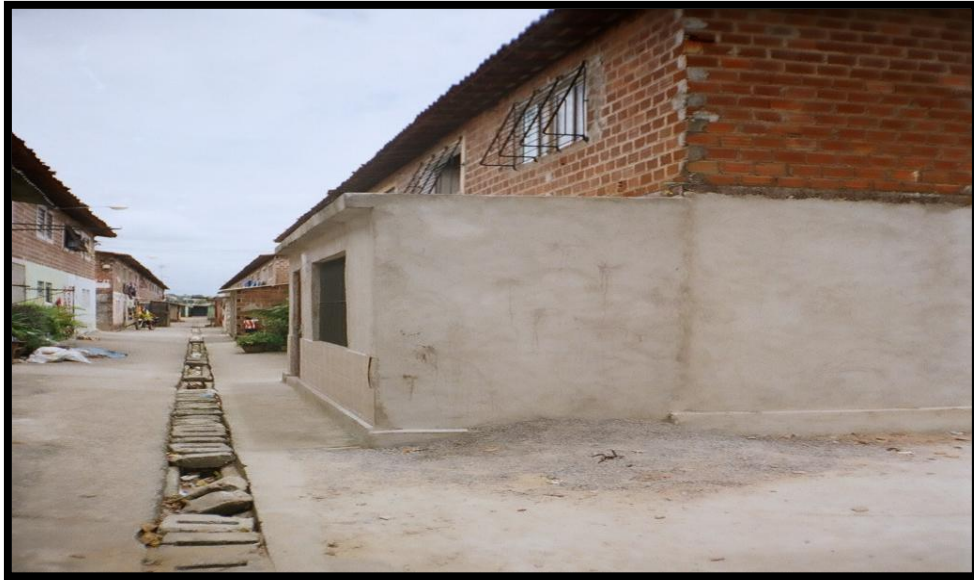
FIGURA 11: Área de circulação – construções irregulares e sem de manutenção FONTE: Autora da Pesquisa, 2010.
