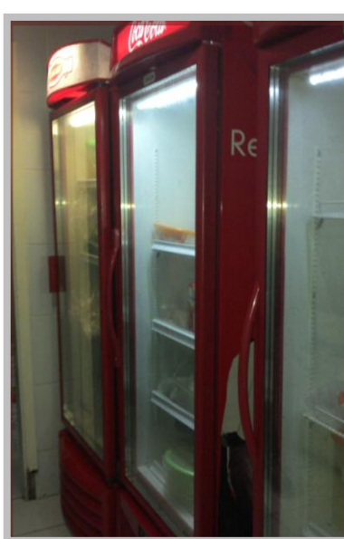
FIGURA 60: Freezers localizados na cozinha, apoio de bebidas.
