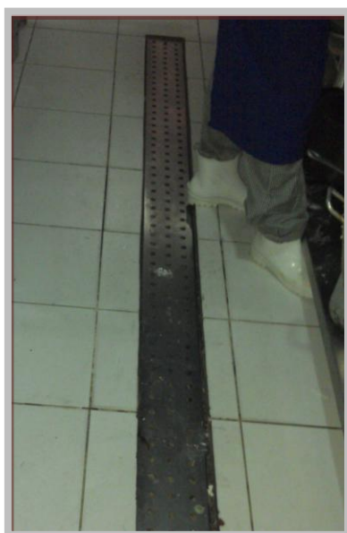
FIGURA 59: Grelha de piso na cozinha. Koy Sushi.
