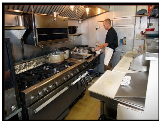
FIGURA 04: Área de cocção de restaurante enfatizando o sistema de preparo e exaustão.
