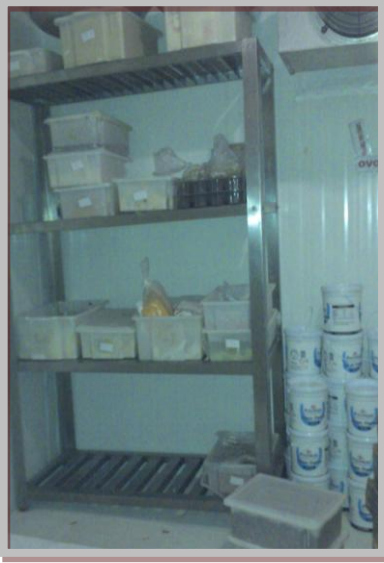
FIGURA 87: Câmara de refrigeração do restaurante.
