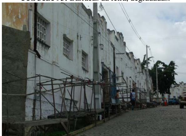
FIGURA 93: Barracas da feira, degradadas.
