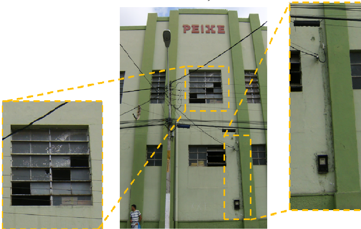
FIGURA 75: Efeitos da deteriorização da fachada da Peixe.
