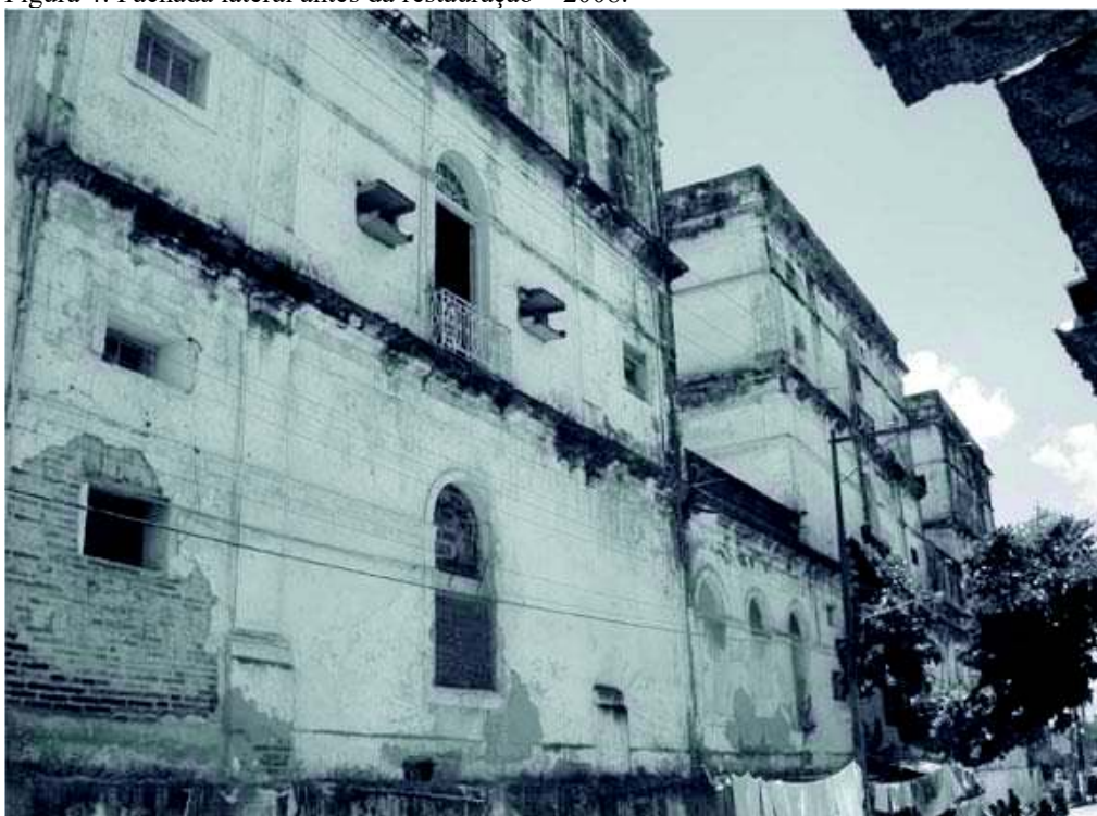
Figura 4: Fachada lateral antes da restauração – 2008.
